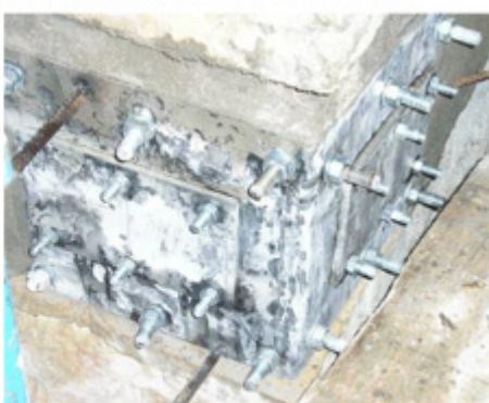
Particolare del nodo al termine delle operazioni di tiro e serraggio. La piastra potrà anche essere nascosta all'interno dello spessore murario.
