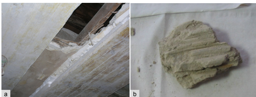
Fig. 2.18 a) – Prelievo lato nord. Fig. 2.18 b) – Campione B lato nord.
