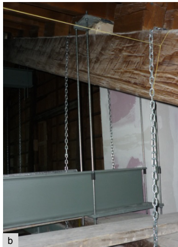
Fig. 4.21 – Particolare della sospensione dell'arcareccio IPE 240 al puntone della capriata n°1 di copertura. Il sistema di sospensione, è stato realizzato mediante due piastre in acciaio, una alla base con funzione di appoggio per il profilo IPE e l'altra in sommità con la funzione di "aggrappo" al puntone delle capriate tenute insieme da quattro tirafondi di dimensioni tali da garantire un'adeguata rigidezza del sistema. Per garantire un perfetto appoggio l'IPE 240 è stata ulteriormente fissata, ad una sola estremità, sulla piastra con dei punti di saldatura. Invece in sommità, si è dovuto aver cura di prevedere, in prossimità della piastra, una zeppe in legno incollata al puntone e opportunamente sagomata per garantire che l'appoggio risultasse perfettamente orizzontale. a) Sospensione prevista da progetto. b) Realizzazione del progetto.
