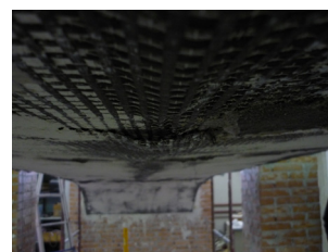
Fig. 3.28 – Particolare della rete rimasta leggermente lasca in prossimità della fessura dopo il sollevamento.
