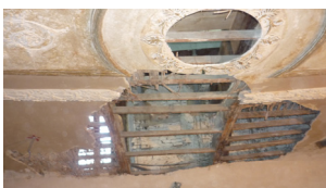
Fig. 4.54 – Mancanze di stuoiato esistenti dovute al degrado causato principalmente dalle infiltrazioni d'acqua.
