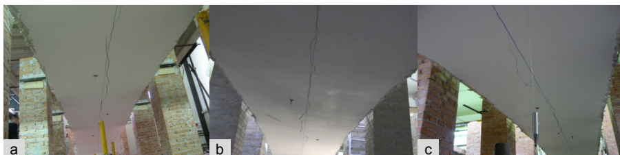
Fig. 3.13 a) – Quadro fessurativo della volta n°1. Fig. 3.13 b) – Quadro fessurativo della volta n°2. Fig. 3.13 c) – Quadro fessurativo della volta n°3.
