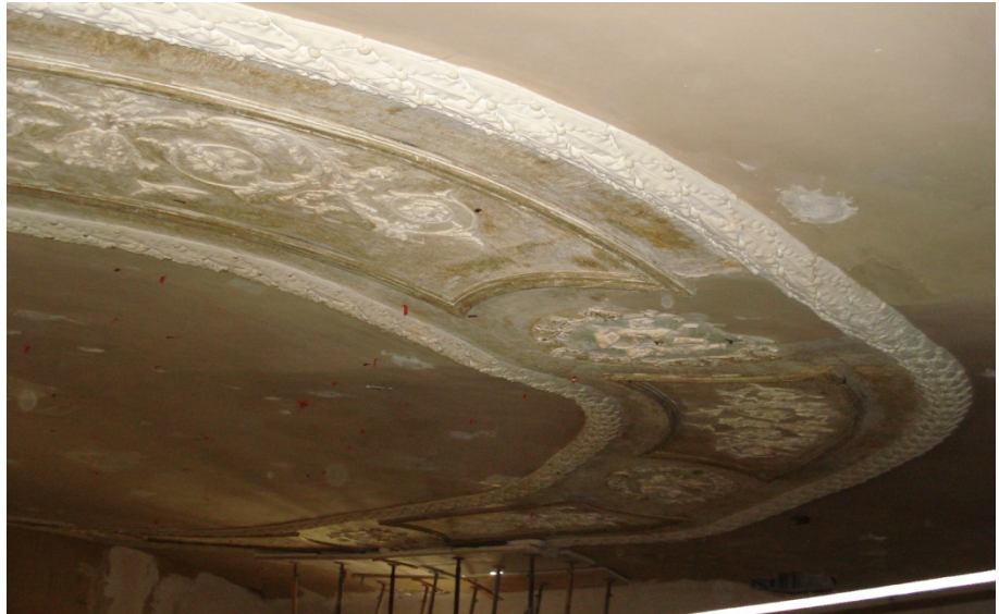
Fig. 4.60 – Il plafone prima dell'intervento di recupero.
