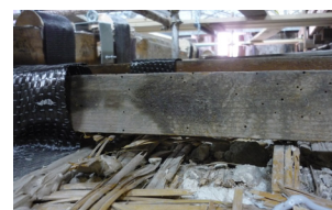
Fig. 4.46 – Distacco di alcune parti dello stuoio dalla struttura lignea all'estradosso.
