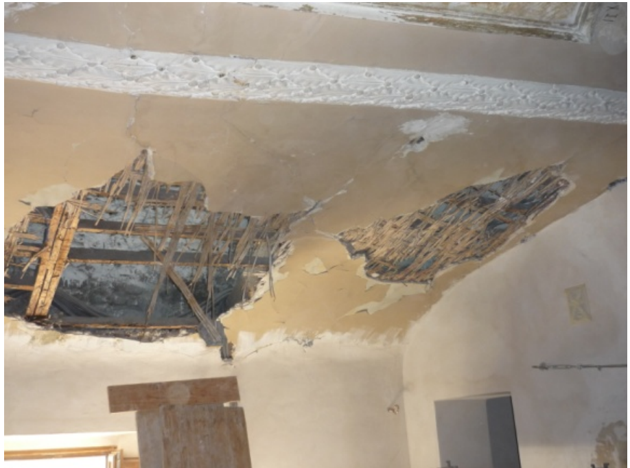
Fig. 2.2 – Porzioni di camorcanna crollate.
