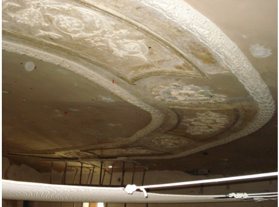
Fig. 2.1 – Intradosso del plafone. Si notano gli avvallamenti della volta.
