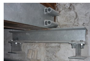
Fig. E.3 – Appoggio della capriata di copertura sulla muratura perimetrale realizzata con HEA 140.
