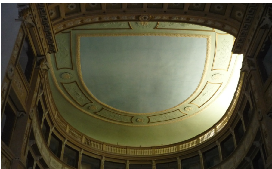
Fig. 2 – Vista dal sotto - palcoscenico del plafone del teatro dei Filarmonici dopo l’intervento di recupero.
